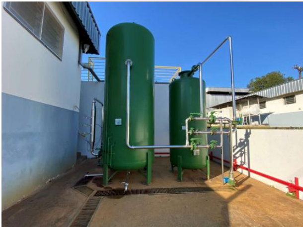
Foto 07: Filtros de tratamento de água (2021)
