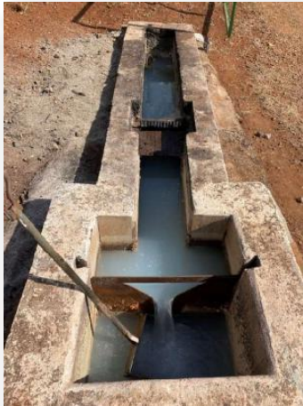
Foto 01: Entrada da ETE (afluente bruto). Tratamento preliminar: grade para remoção de sólidos grosseiros e sistema de remoção de areia (2021)
