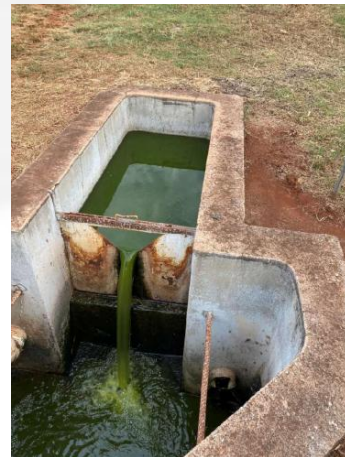
Foto 04: Saída da ETE: efluente tratado. Medidor de vazão: vertedor triangular (2021)
