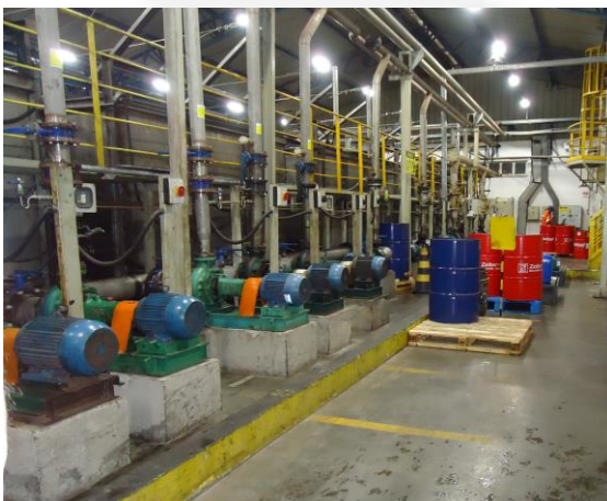
Foto 05. Área de manuseio e armazenagem de produtos químicos.
