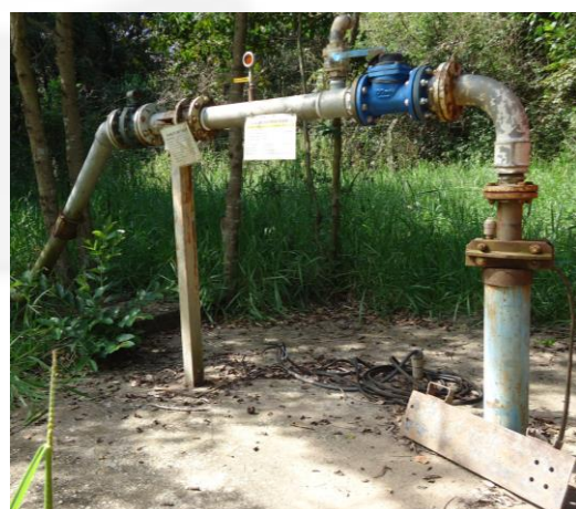
Foto 06. Um dos poços tubulares.
