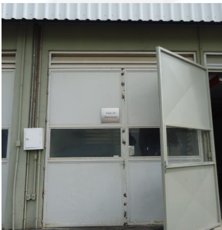
Foto 03. Central de armazenamento temporário de resíduos sólidos.
