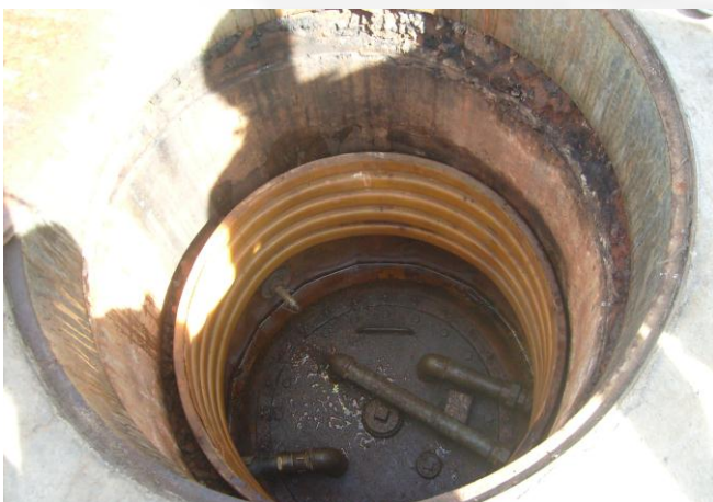
Foto 09. SUMP na boca de visita do tanque
