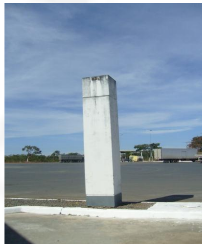
Foto 02. Respiros dos tanques
