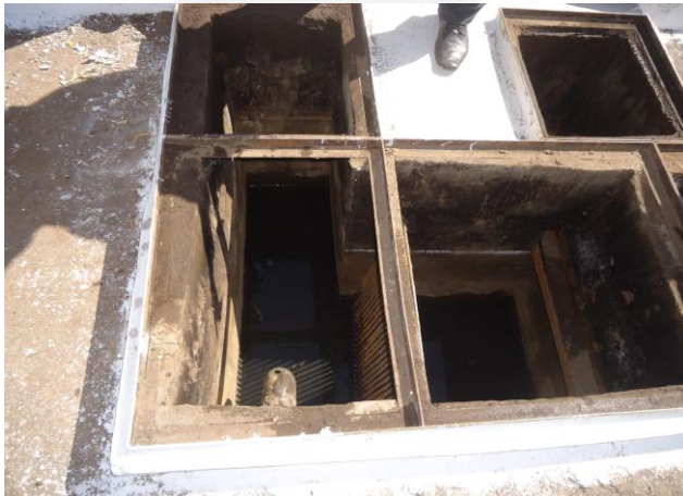
Foto 07. Caixa Separadora de Água e Óleo
