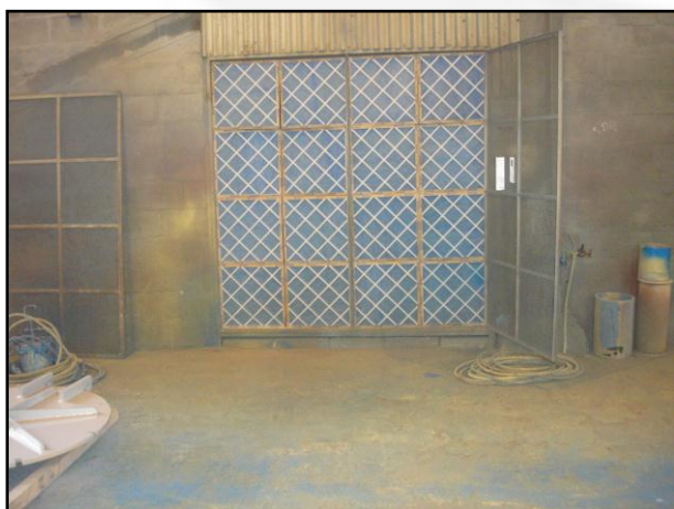
Foto 05: Exaustor com filtros para captar a névoa de tinta.
