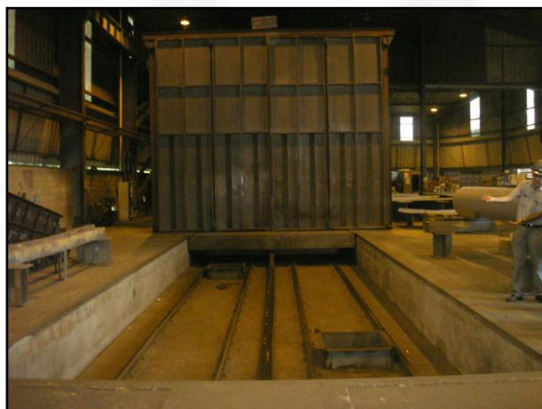
Foto 04: Cabine de Jateamento de Granalha.
