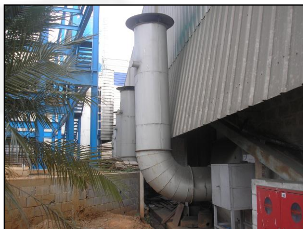
Foto 06: Chaminés da cabine de pintura.
