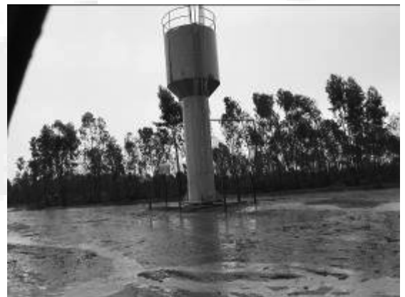
Figura 04. Caixa de armazenamento de água na UPC.
