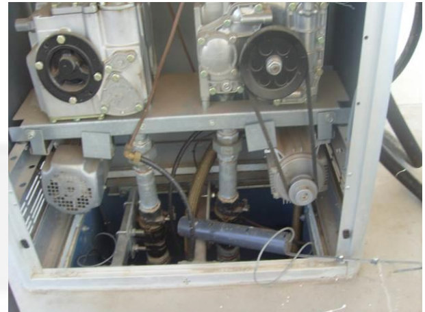
Foto 06. Sensor de monitoramento no sump da bomba
