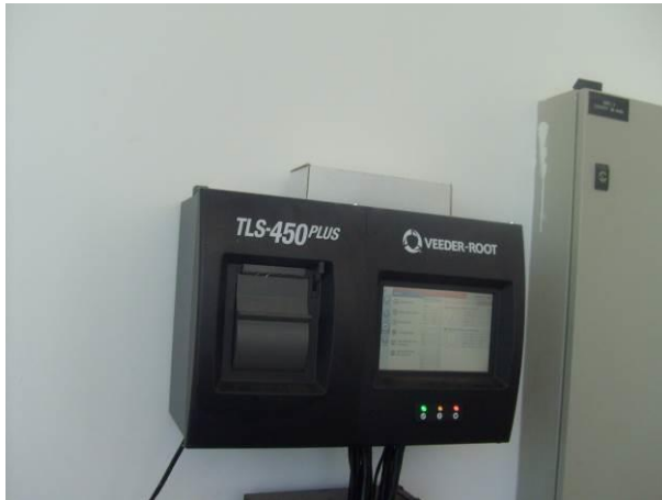
Foto 05. Equipamento de monitoramento intersticial e monitoramento dos sumps.
