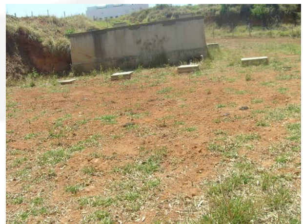
Foto 04. Sistema de tratamento de efluentes líquidos
