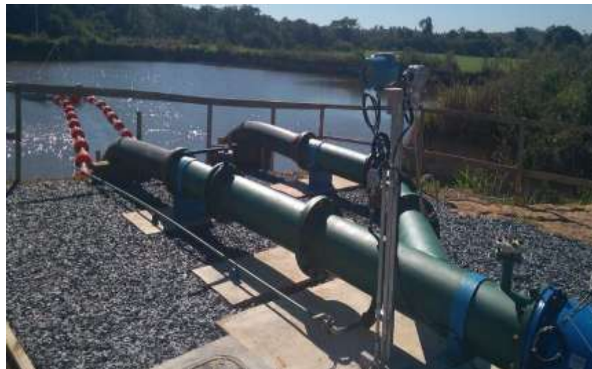
Captação de água no córrego Moreira
