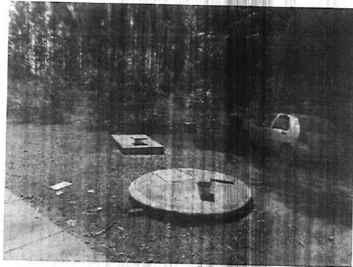
Foto 9: Conjunto Fossa Séptica da Fazenda Rio Velho próximo ao alojamento.
