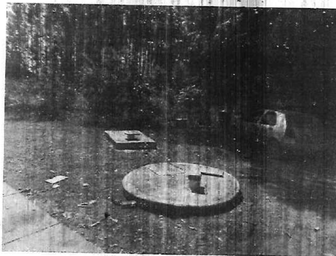
Foto 82: Sistema de Fossa Séptica e Filtro que atende o alojamento.
