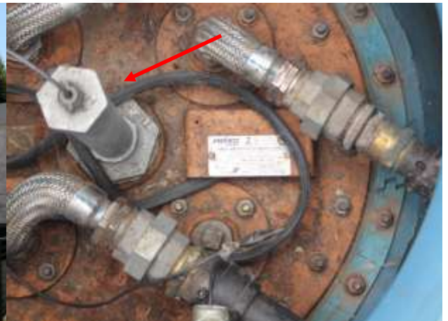
Foto 8: Monitoramento intersticial nos tanques.
