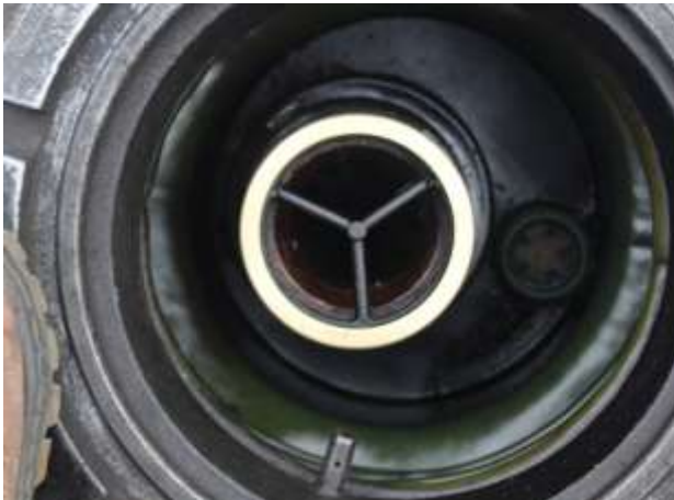
Foto 5: Local para descarga de combustível com sump, cruzeta e válvula anti-transbordamento (descarga selada).
