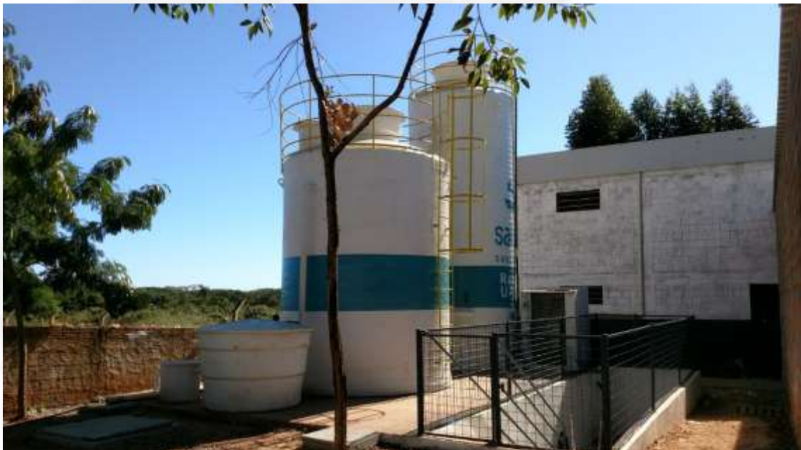
Figura 6.1: Nova ETE do Posto Chimba.
