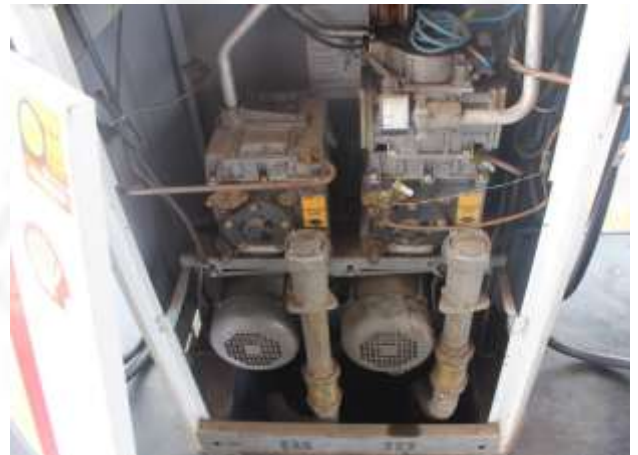
Foto 2: bomba de abastecimento equipada com sump (caixa de contenção) e checkvalves.
