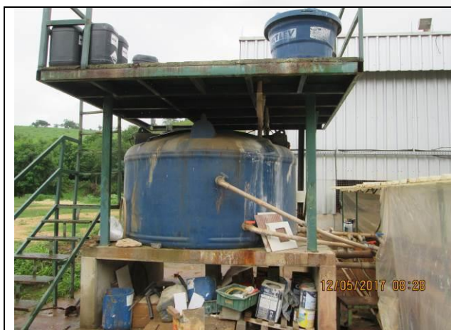
Foto 4: ETE industrial com o leito de secagem coberto ao lado
