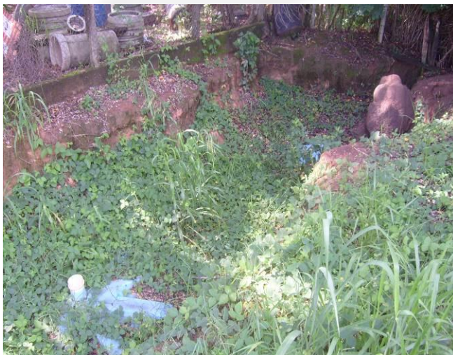
Foto 9: Estação de Tratamento dos efluentes sanitários.
