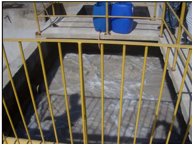
Foto 02. Tratamento de efluentes do Matadouro S. Geraldo.
