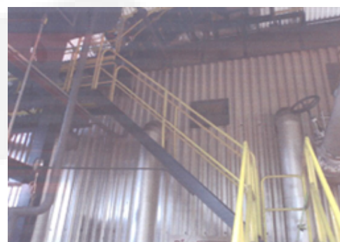
Foto 12. Caldeira do sistema de geração de vapor
