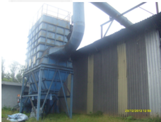
Foto 01. Galpão de descarga de carvão enclausurado, com filtro de manga.
