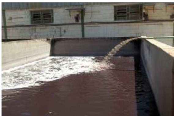
Foto 05. Parte da ETE Industrial.
