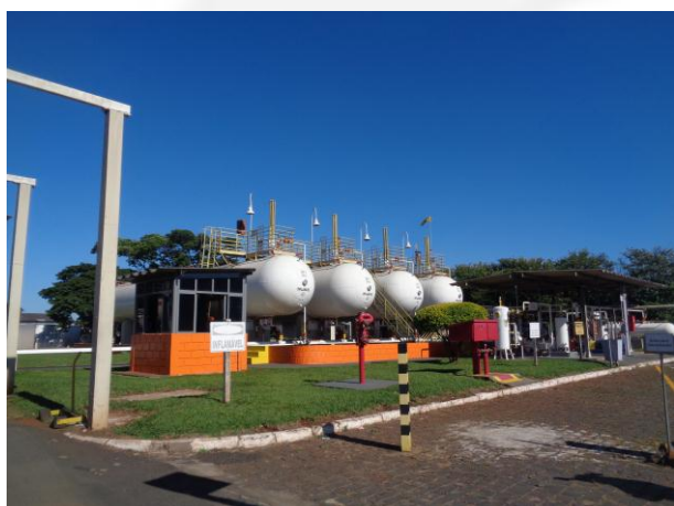
Foto 01. Tanques de armazenamento de GLP.
