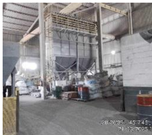
Foto 06. Filtro de mangas.
