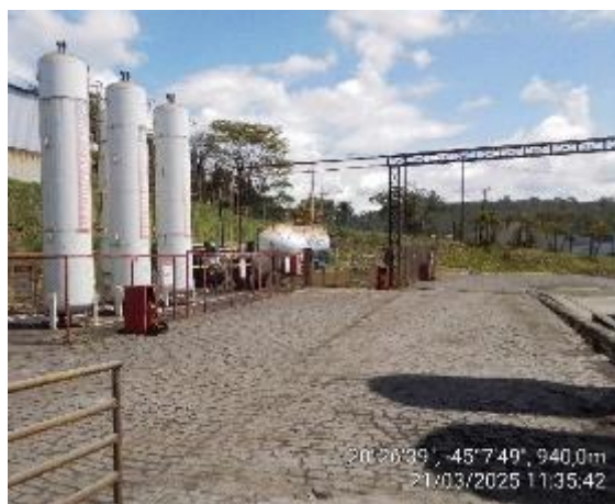
Foto 03. Tanques de GLP e via calçada.
