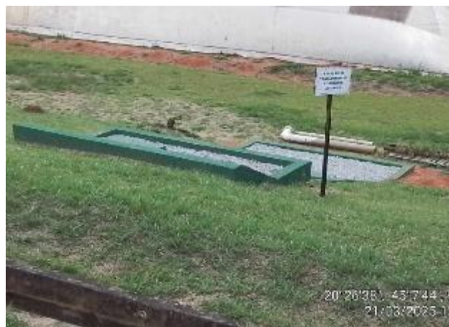
Foto 11. Tratamento de efluentes.
