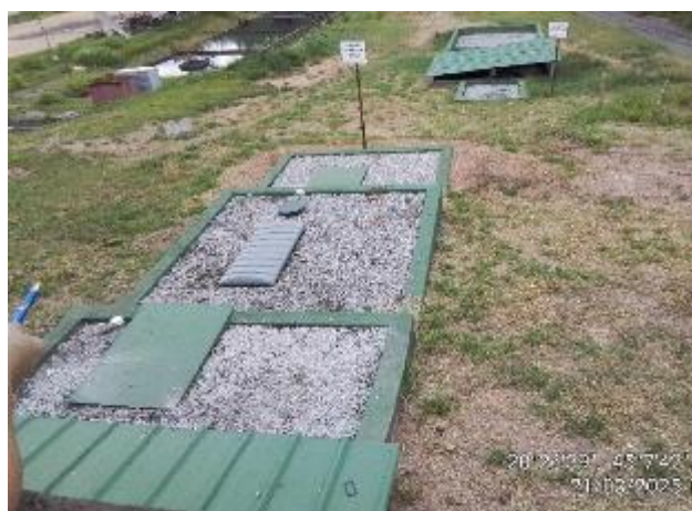
Foto 10. Tratamento de efluentes.
