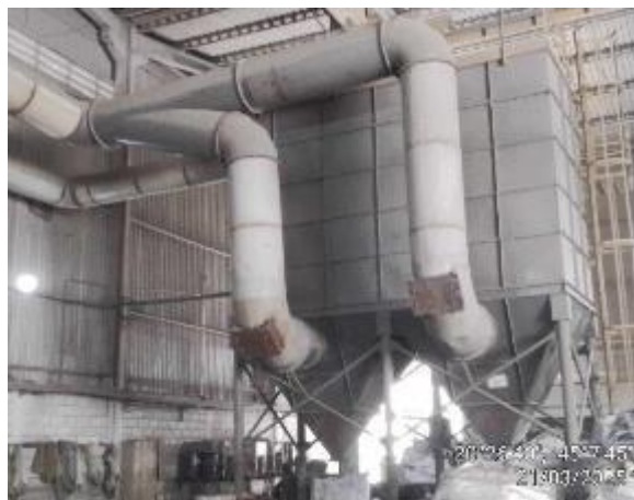
Foto 08. Filtro de mangas.
