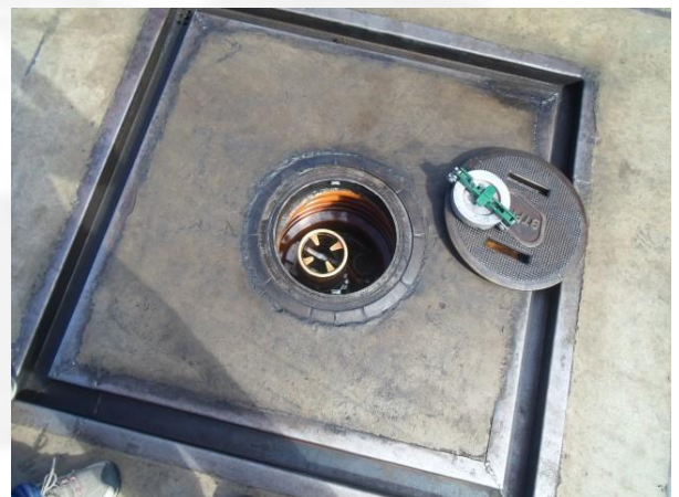
FOTO 04- Boca de descarga de combustível
