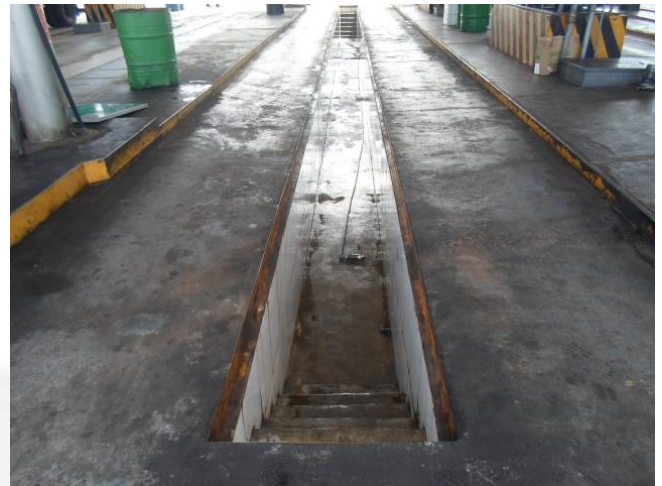
FOTO 06- Rampa de troca de óleo
