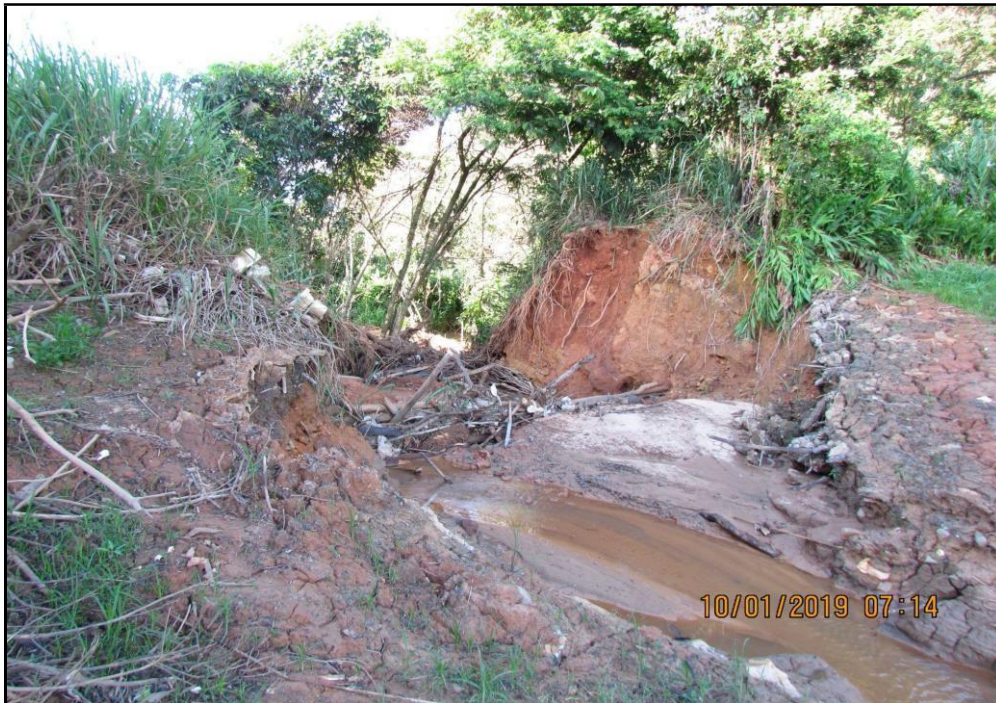
Fotografia do aterro do açude em 10 de janeiro de 2019, quando ocorreu o rompimento da barragem.
