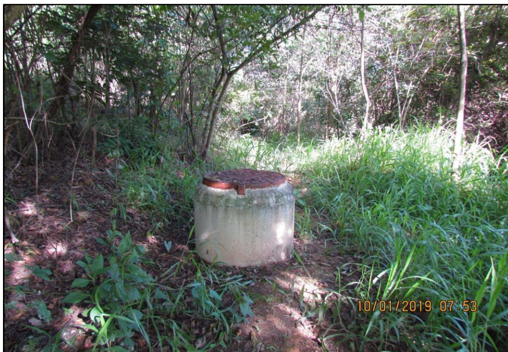
Sistema de esgotamento sanitário do Bairro Cabral localizado na área verde anexa à Mata do Confisco.
