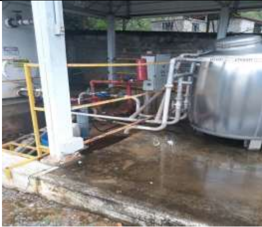
Foto 05: Poço Tubular com Sistema de Tratamento
