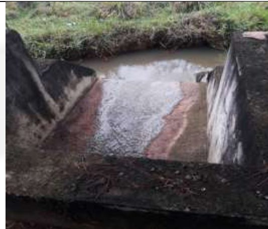
Foto 10: Ponto de Lançamento do Efluente Final Tratado
