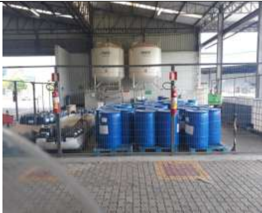
Foto 01: Depósito de Produtos Químicos.
