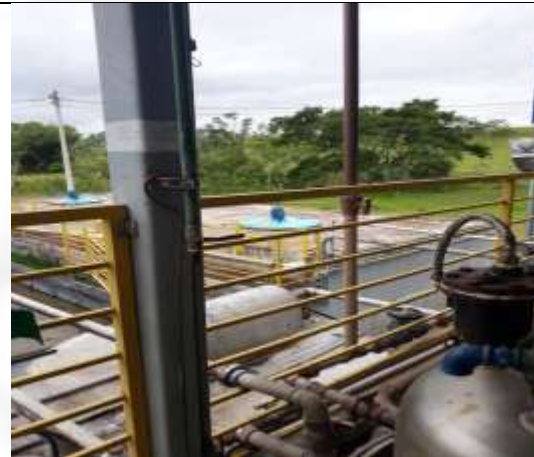
Foto 08: Vista Parcial da ETE destacando os Aeradores
