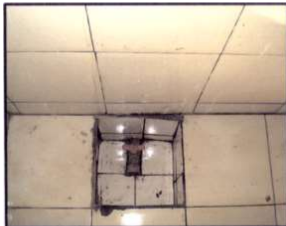
Figura 4. Caixa de passagem dos efluentes líquidos oleosos no depósito de resíduos. Fonte: SEAM, 2015.
