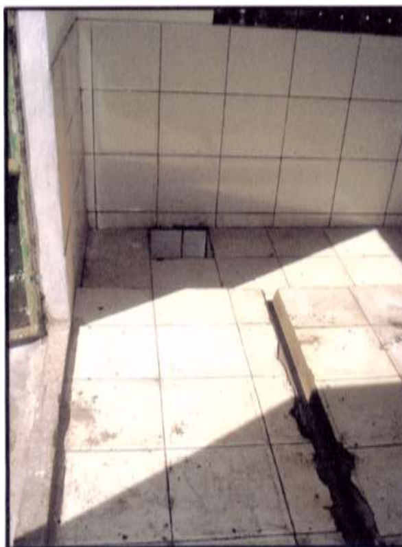
Figura 3. Canaletas de coleta dos efluentes líquidos oleosos no depósito de resíduos. Fonte: SEAM, 2015.
