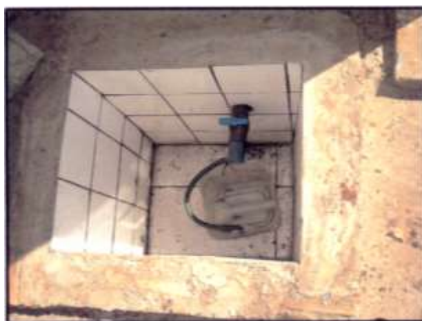
Figura 5. Caixa de coleta dos efluentes líquidos oleosos drenados do depósito de resíduos. Fonte: SEAM, 2015.
