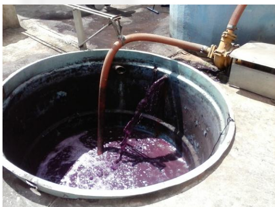
Foto 3: Estação de tratamento de efluentes industriais.
