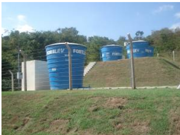
Foto 01: ETA já instalada no empreendimento.
