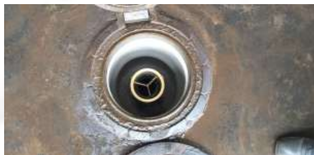
Sump na boca de descarga
