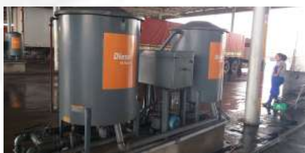
Filtros de diesel / pista de abastecimento
