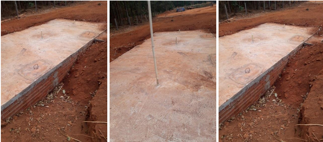
Fotos 8, 9 e 10 – Sistema de tratamento de efluentes sanitários.
