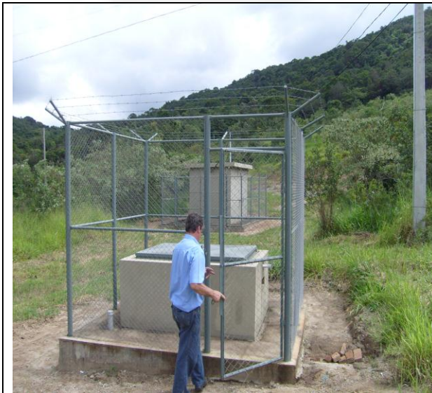
Foto 03: Poço Tubular (Fonte Olhos d'Água II)
