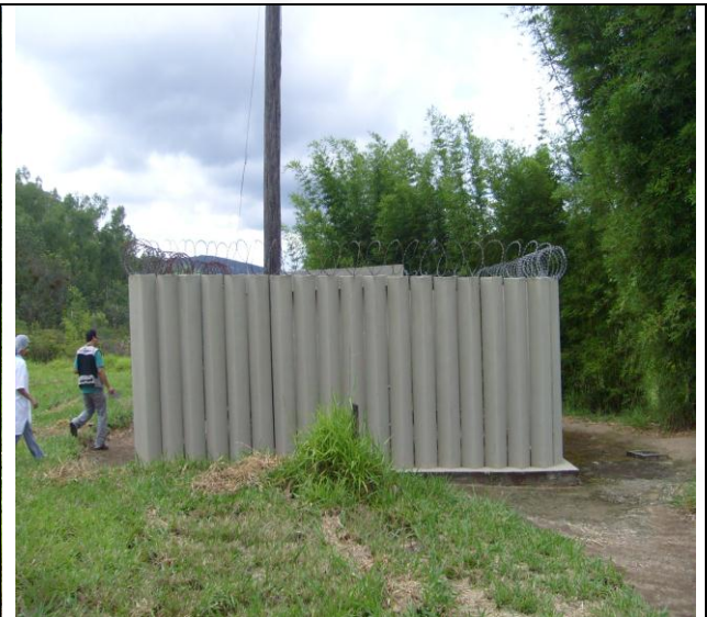
Foto 04: Poço tubular (Fonte Olhos d'Água III)
