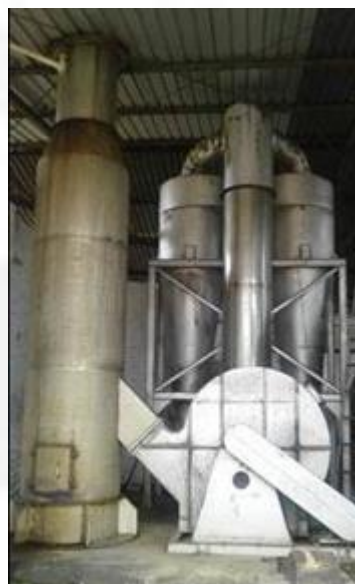
Foto 03. Ciclone da caldeira.
