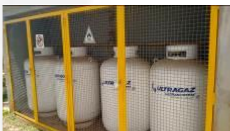
Foto 03. Armazenamento de GLP.
