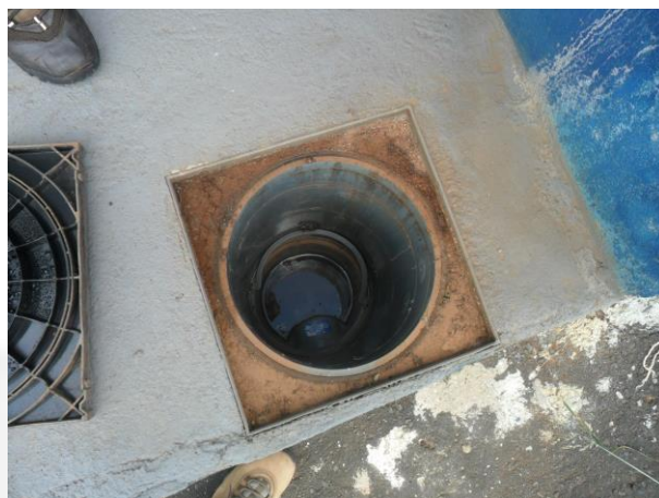
Foto 06. Sistema de gradeamento para efluentes industriais.
