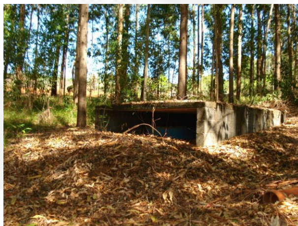
Foto 04. Fossa séptica e sumidouro.
