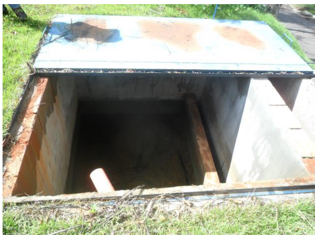
Foto 05. Caixa de equalização de efluentes industriais
