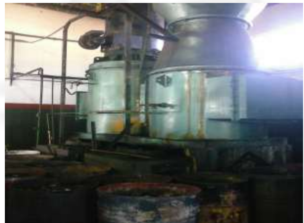
Foto 02. Lavador de gases
