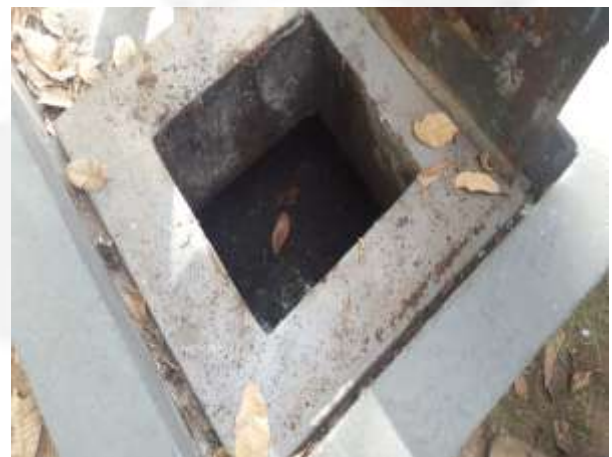
Foto 10. Caixa do Sistema de Tratamento de efluentes líquidos
