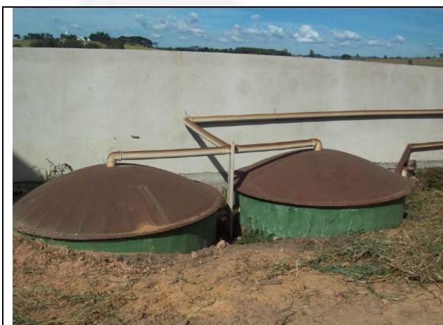
Foto 3. Sistema de Tratamento de Efluente líquido sanitário, composto de fossa séptica e filtro anaeróbio.
