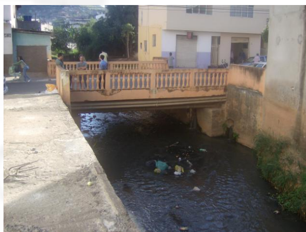
Foto 10: Travessia sobre o córrego São João. Observar grande quantidade de lixo lançado no curso d'água.
