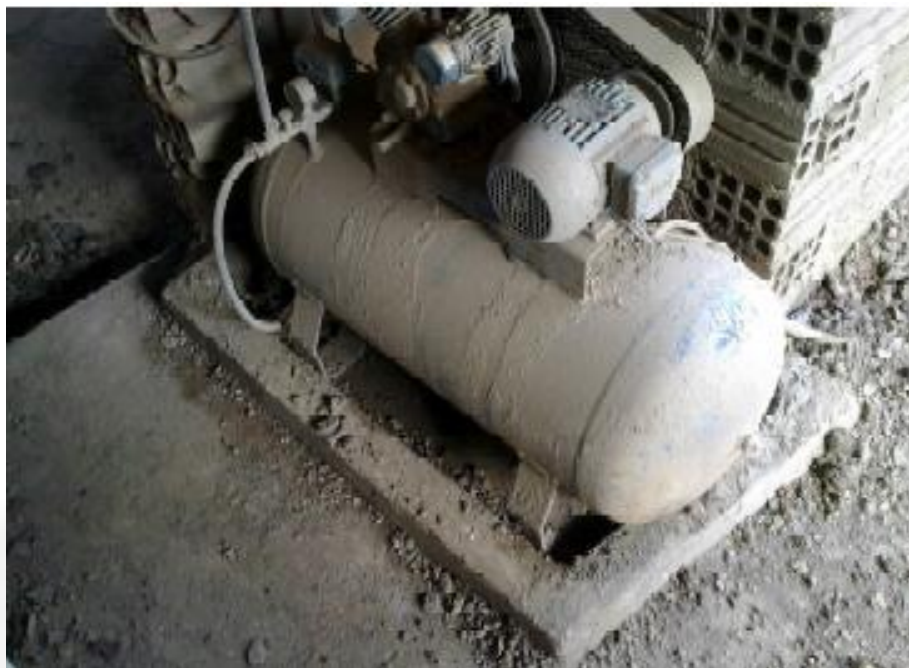
Figura 3. Bacia de contenção instalada em torno do compressor
