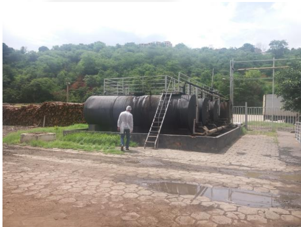
Foto 08. Depósito Óleo Diesel.
