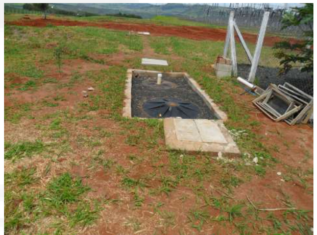
Sistema Fossa Séptica Subestação de Estreito
