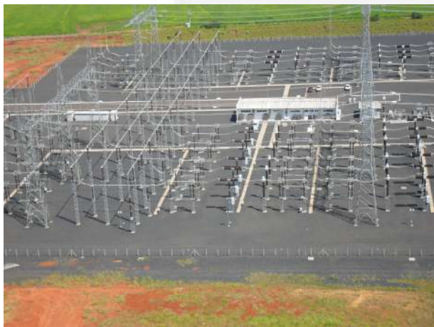
Vista aérea Subestação de Estreito
