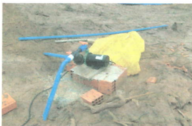
Foto: Estrutura para distribuição de água.
