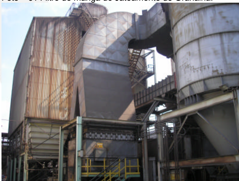
Foto – 02 Sistema de controle de emissões atmosféricas com filtros de manga e ciclone da área da Aciaria.
