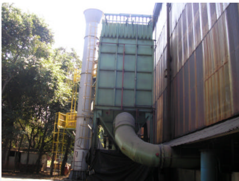
Foto – 01 Filtro de manga do Jateamento de Granalha.
