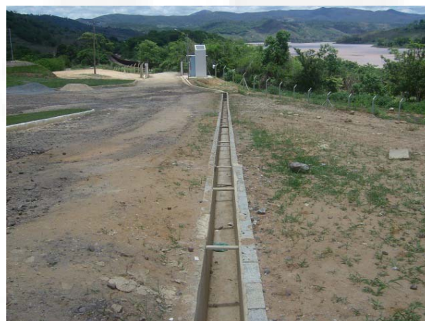
Foto 04. Drenagem Pluvial na Área do Empreendimento
