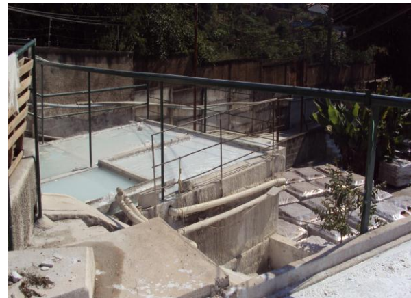
Figura 8 – Caixas de sedimentação da ETEI
