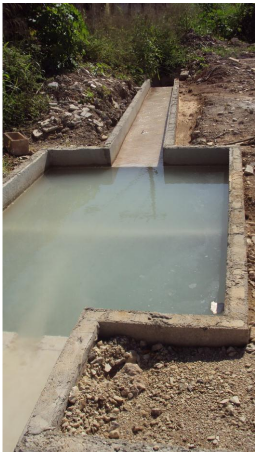
Figura 9 – Sistema de decantação (sistema de drenagem pluvial).
