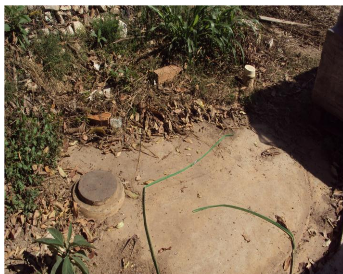
Figura 10 – Fossa séptica e filtro.
