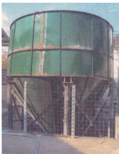
Figura 3 – Tanque de recepção do efluente líquido
