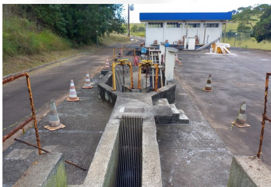
Figura 3: Vista geral do tratamento preliminar e elevatória de esgoto
