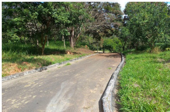
Figura 9: Vista geral de acesso interno da ETE e detalhe do local de passagem, drenagem pluvial construídas em tubulações de concreto meia cana DN 200
