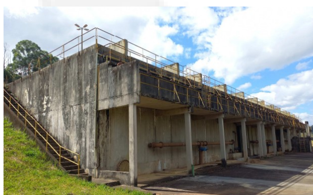
Figura 5: Vista geral dos reatores
