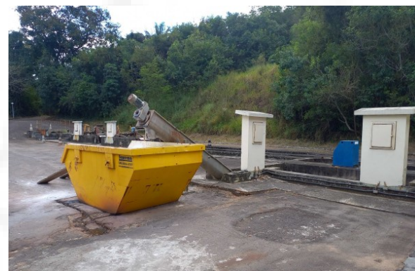
Figura 4: Vista geral da caçamba e do sistema preliminar de tratamento
