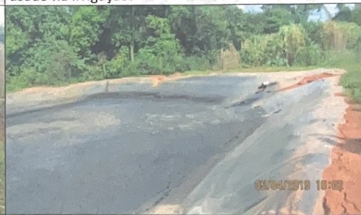
Foto 06: Vista parcial da lagoa de dejetos, com sinais de danos na impermeabilização.
