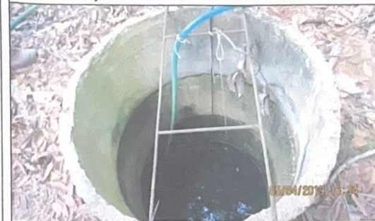
Foto 11: Cisterna utilizada na área de abate de peixes.
