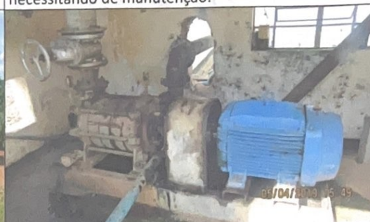
Foto 04: Vista de um dos conjuntos motobomba usado na irrigação.
