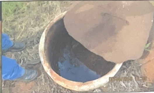
Foto 02: Detalhe de uma fase da caixa separadora necessitando de manutenção.
