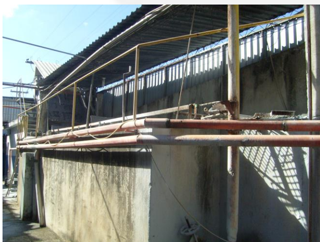
Foto 03. Canaletas de recirculação da água
