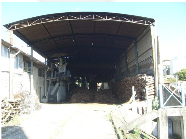
Foto 01. Galpão onde se localiza as caldeiras
