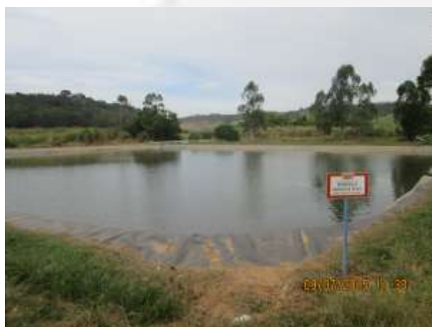
Foto 01. Tanque de aerção
