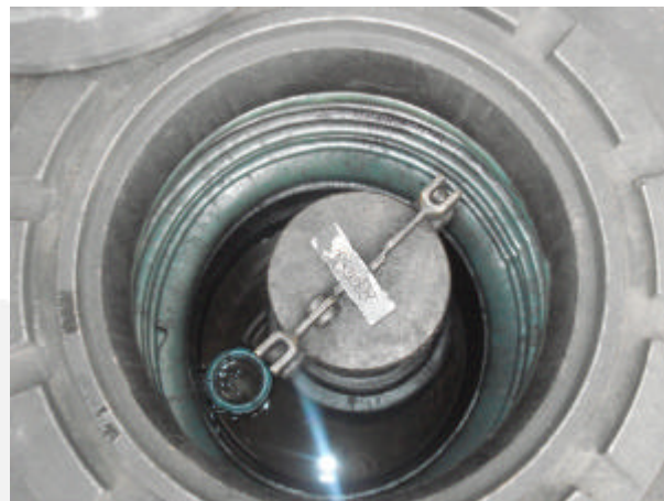
Foto 02. Tanque de abastecimento.
