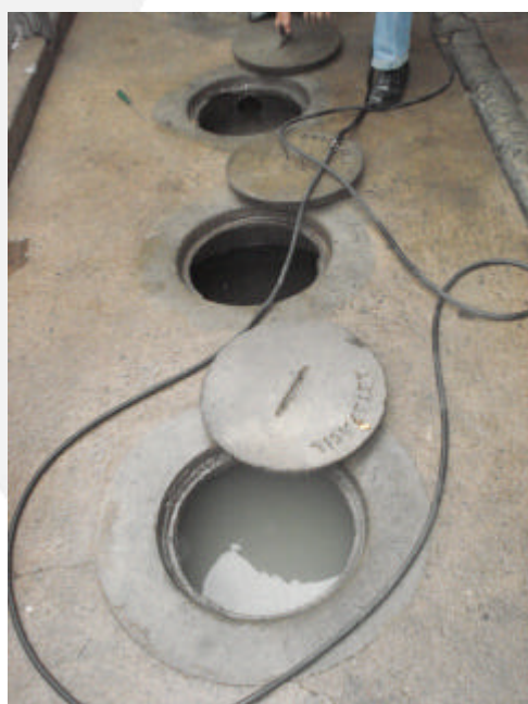
Foto 03. Caixa Separadora de Água e Óleo.
