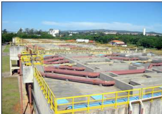
Vista parcial dos reatores UASB.
