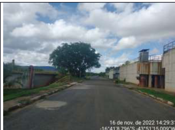
Foto 01. Vista geral dos reatores e filtros biológicos
