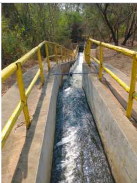
Foto 03: Canal de lançamento do efluente tratado
