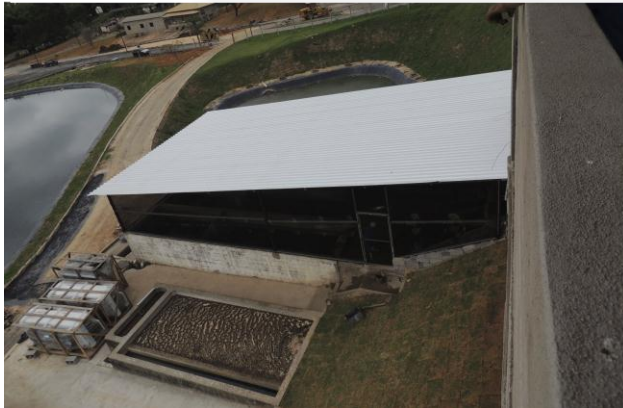
Foto 1. Vista parcial da ETE constando o enclausuramento do sistema primário
