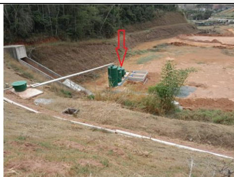
Figura 05: Estação de Tratamento de Efluentes instalada.
