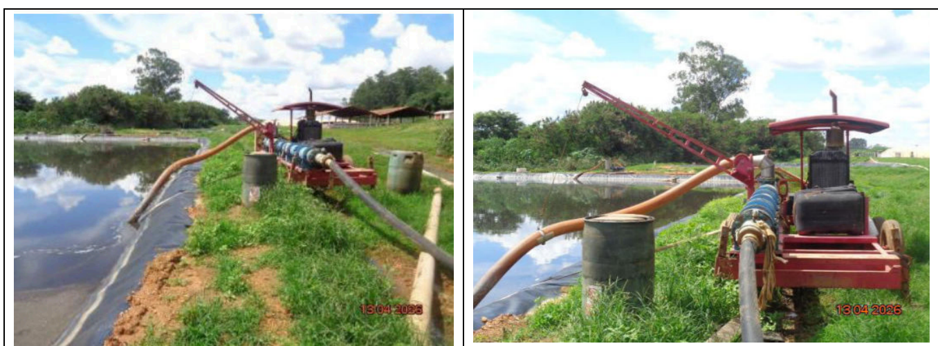
Foto 3: Sistema de bombeamento de dejetos (Fonte: RADA, 2026).
