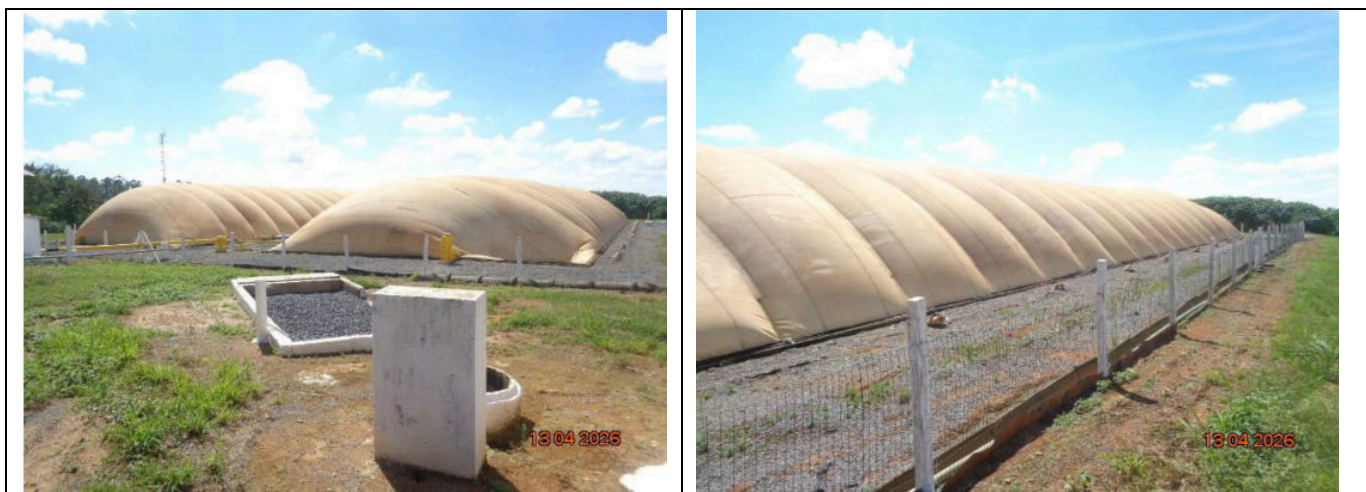
Foto 1: Biodigestores (Fonte: RADA, 2026)
