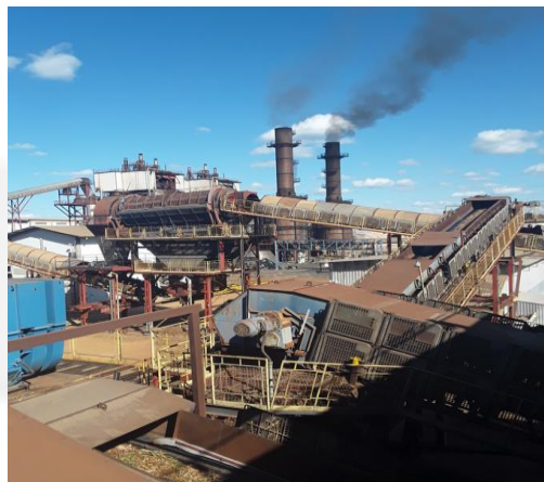
Foto 02. Vista das caldeiras
