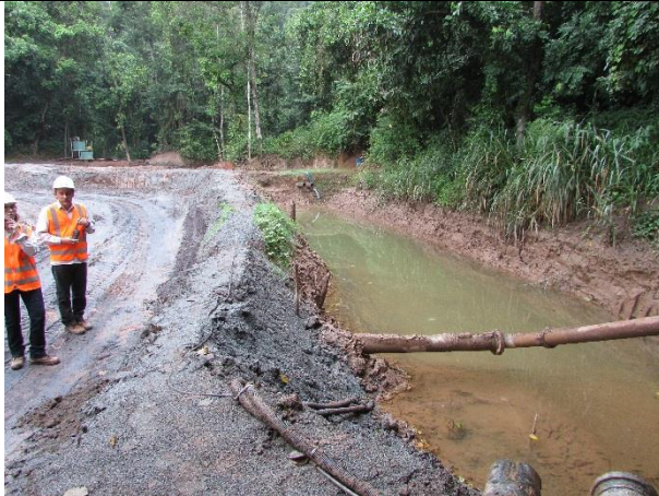
Fotografia 07: Conjunto de Baías do Booster .
