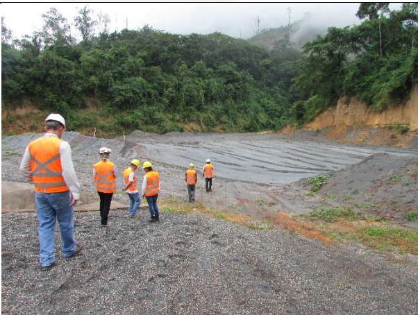
Fotografia 05: Rejeitos acumulados sobre o antigo reservatório da Barragem (atual Pilha da Voçoroca).
