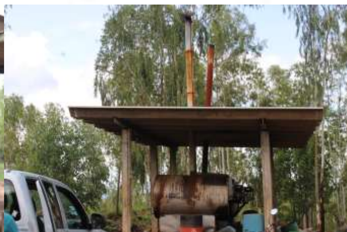
Foto 46: Chaminé do desidratador.
