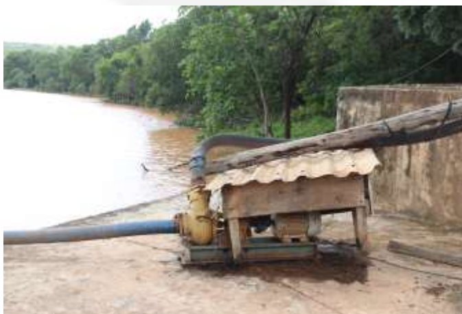
Foto 47: Ponto de captação superficial no Rio do Vale sem outorga.
