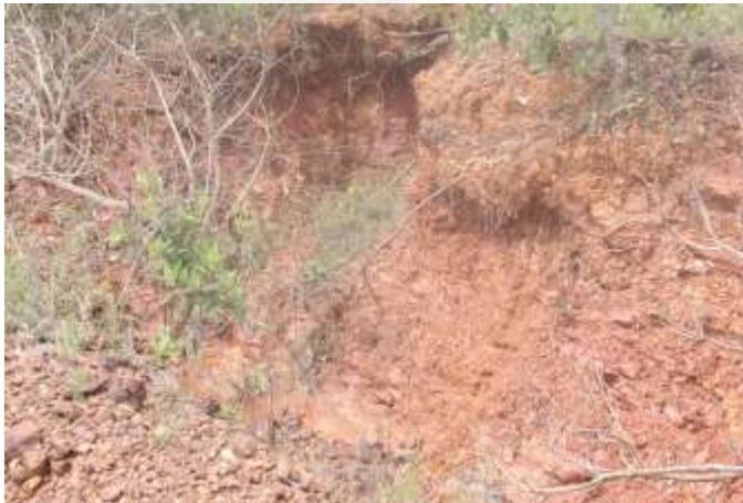
Foto 57: Processo erosivo em área destinada a implementação de PTRF.
