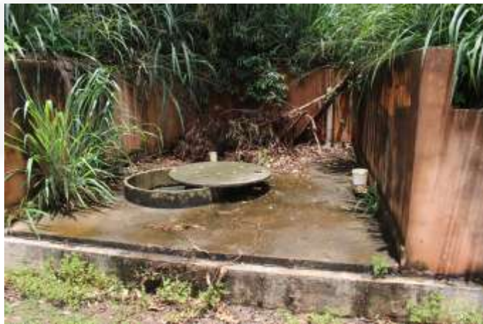
Foto 40: Sistema fossa séptica/filtro anaeróbio/sumidouro com funcionamento inadequado.
